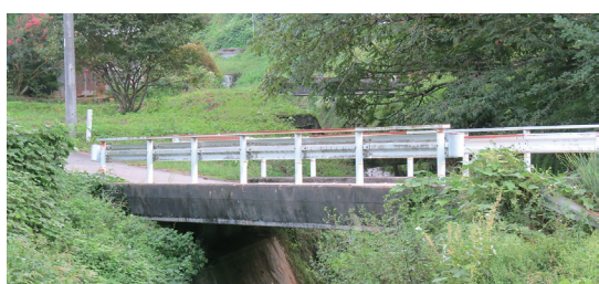
工事が待たれる橋（杉沢）
