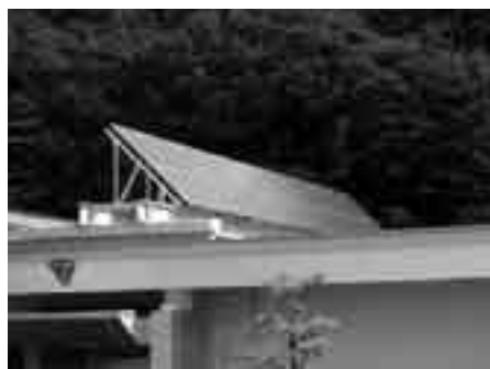
太陽光発電システム
