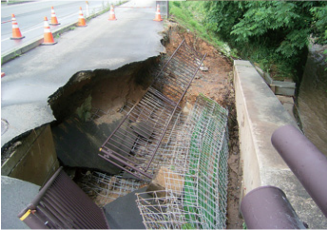
▲国道348号線（十王）。斜面の土が崩れ歩道の路面も大きく損壊した。
