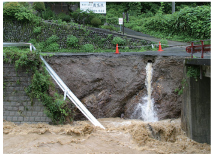
▲町道黒鴨川前線（黒鴨）。住民が避難後に通行止めとなった。
