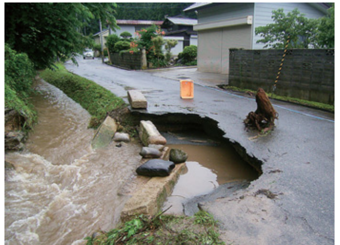
▲谷町八ヶ森（鮎貝）。路面が大きく削られ通行止めに。
