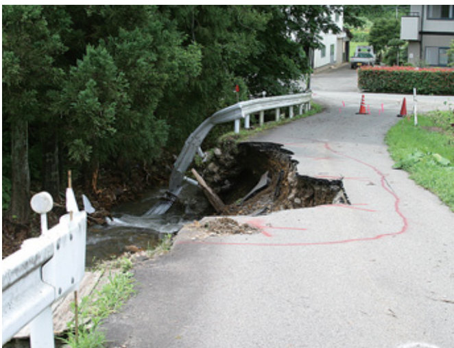
▲町道中滝野線（滝野）。ガードレールごと大きく崩落し通行不可となる。
