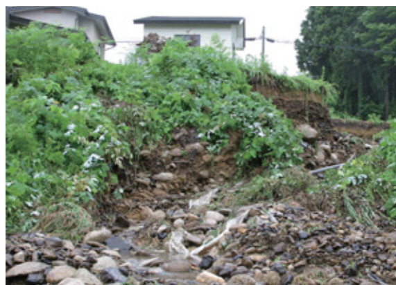
▲畑が崩れてすぐ脇の建物にも危険が迫った（深山）。崩れた土砂が町道橋本新田線をふさぎ一時通行止めに。
