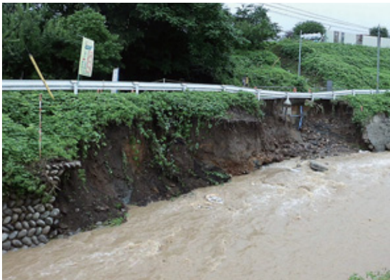
▲貝生川の護岸も大きく削られた（貝生）。
