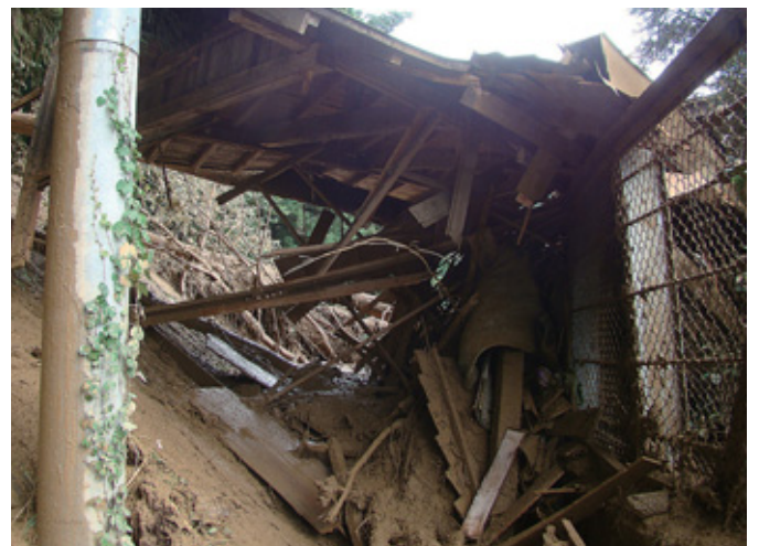
▲宝山公園の土砂崩れが住宅裏のフェンスを越える（町下）。
