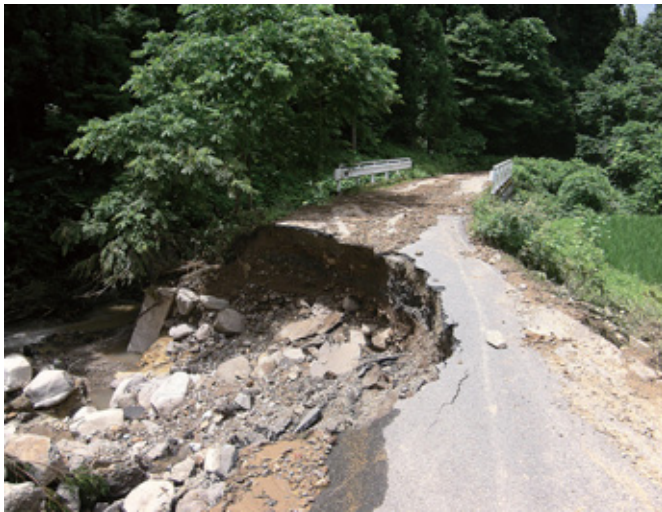
▲林道東部白鷹線。路面が広範囲に削られている。
