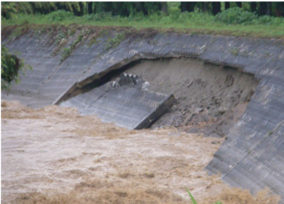
▲町内各所で川の護岸が損壊。実淵川（黒鴨）。
