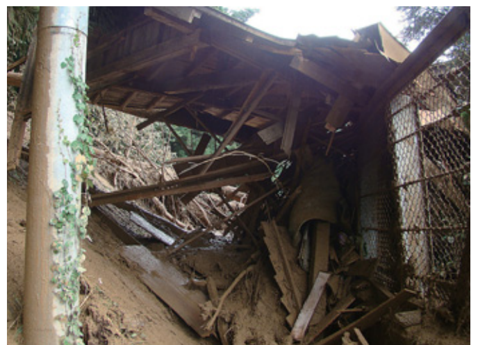
▲宝山公園の土砂崩れが住宅裏のフェンスを越える（町下）。
