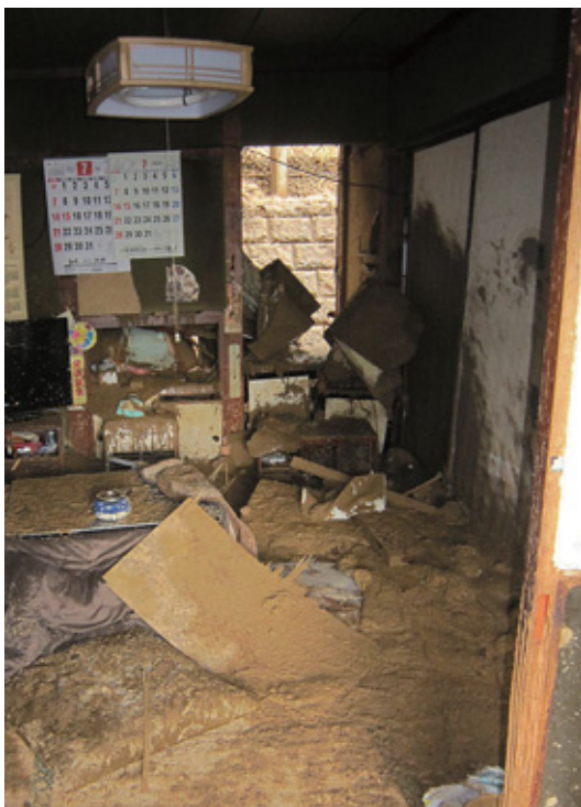
▲右の写真の土砂が住宅を直撃。
