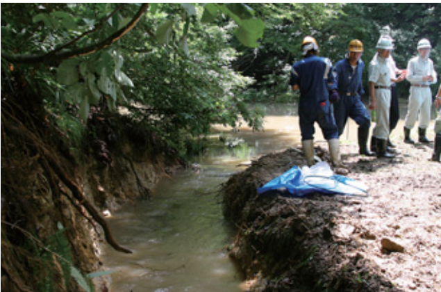
▲7月28日、前日の雨によって細野沼が決壊するおそれがあり排水作業を行う（滝野）。
