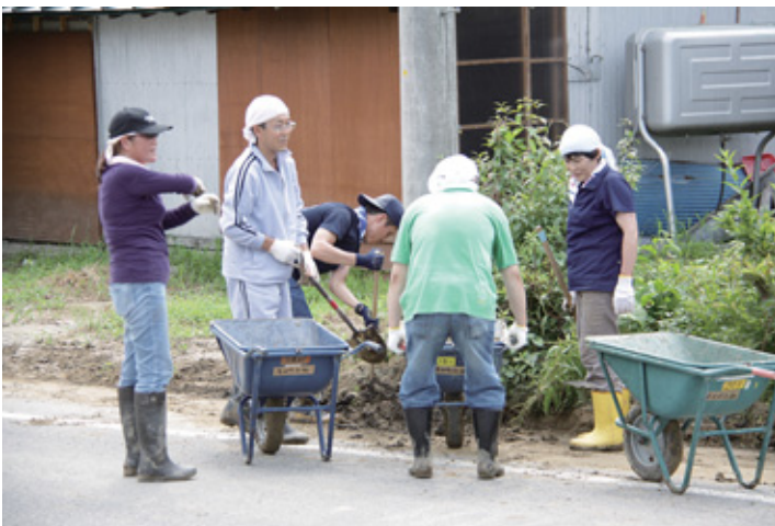
▲7月24日に白鷹町災害ボランティアセンターが設置され、25日～28日まで、浸水した家屋の畳などの運び出しや家屋・道路の泥の除去、土のう積み上げ作業などに、町内外から、のべ168人の参加をいただいた。「(東日本大震災で)お世話になったので。」と、宮城県から来てくれたかたも。
