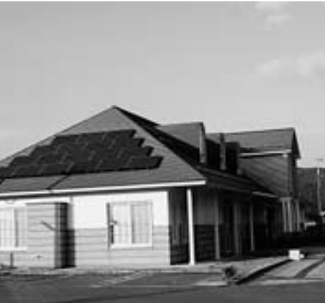
太陽光発電（荒砥・八幡二公民館）
