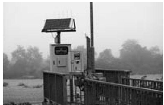
河川管理等画像受信機（最上川堤防）
