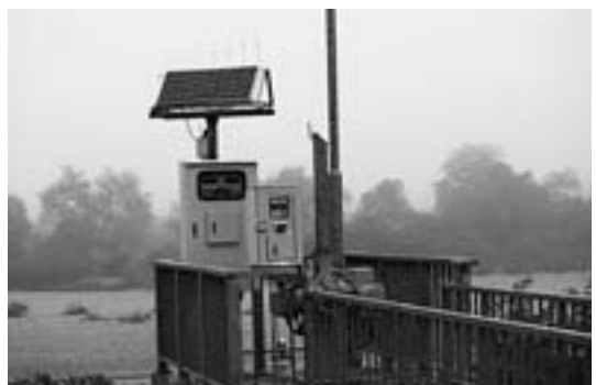
河川管理等画像受信機（最上川堤防）
