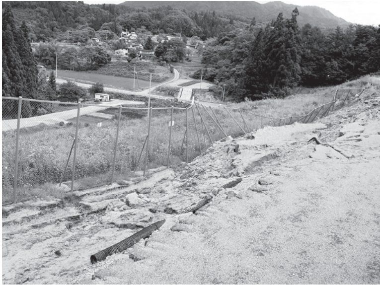
鷹山小学校の法面崩壊の現場
