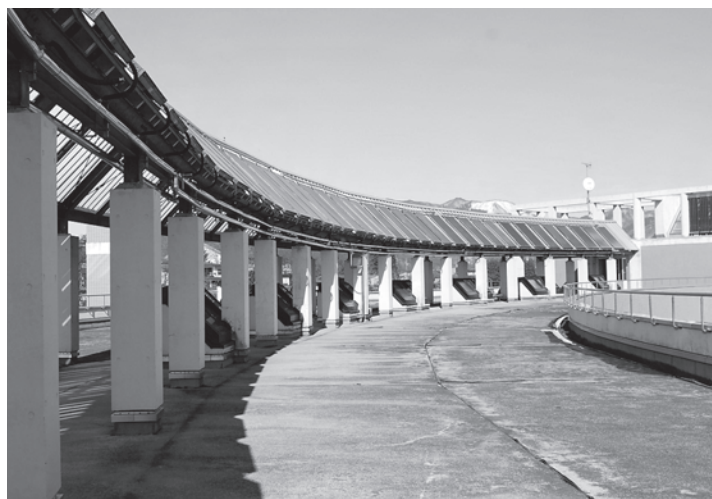
傷みが目立つ町立病院（屋上）
