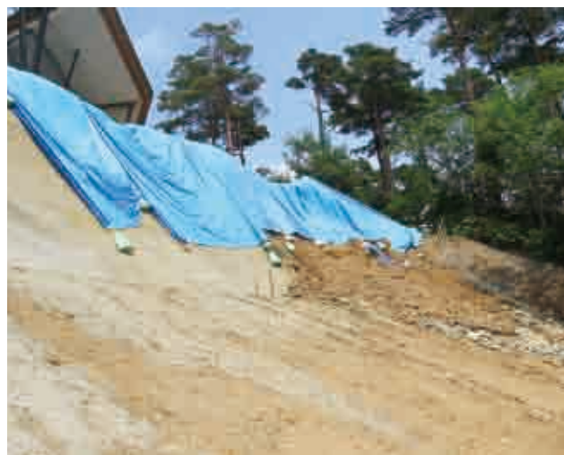
パレス松風露天風呂うら斜面崩落現場
