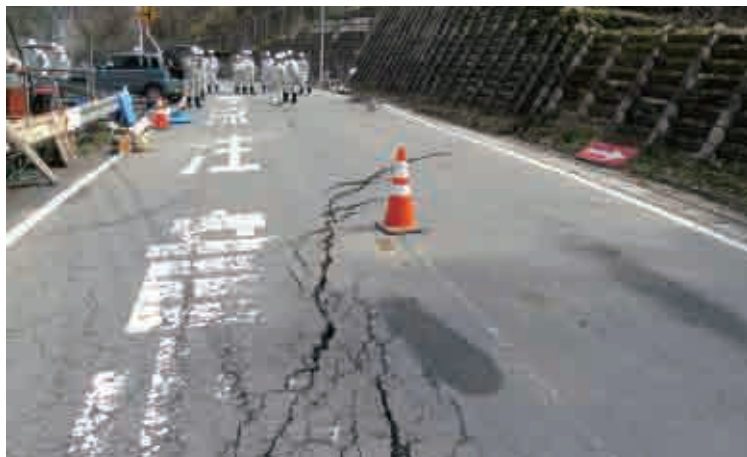
国道287号災害現場
