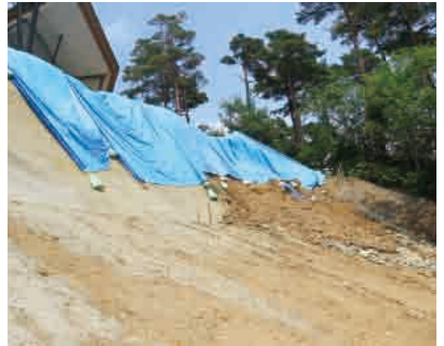
パレス松風露天風呂うら斜面崩落現場
