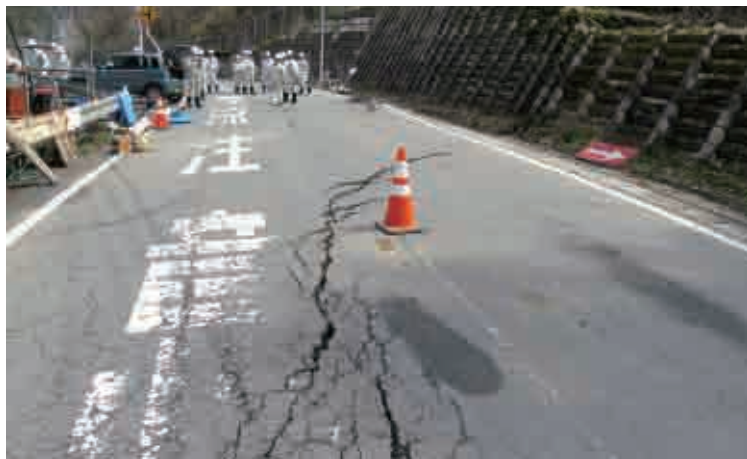
国道287号災害現場
