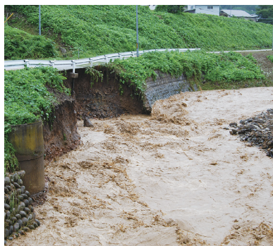
豪雨により河川が氾濫し危険な状態
