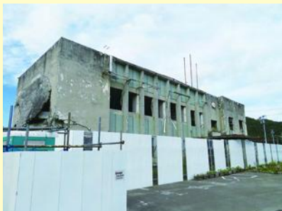
被災した大槌町役場
