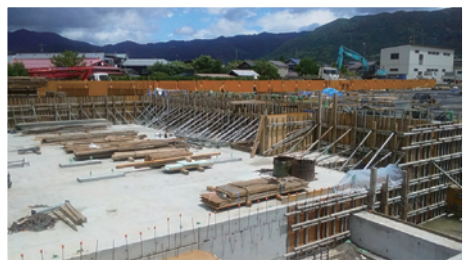
2mほどの段差がある
