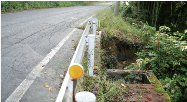
路面崩壊の坂下平田中山線
