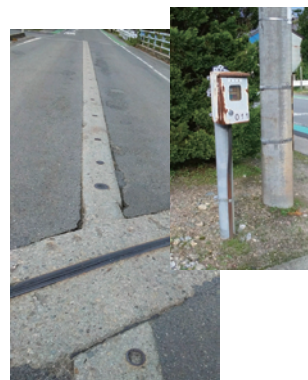
水源が枯れた消雪設備
