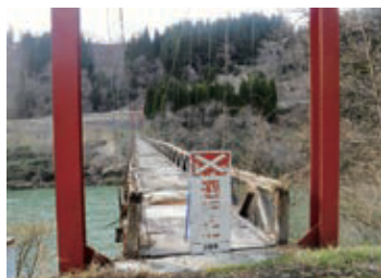
老朽化で通行止め
