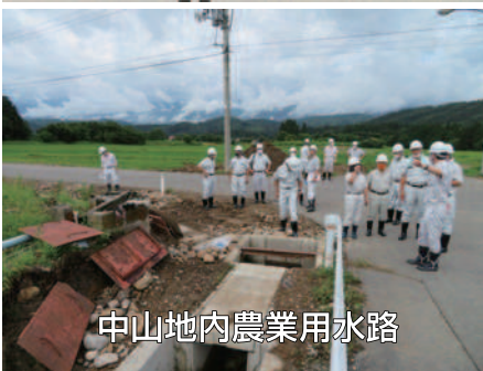
坂下平田中山線土砂崩れ現場
