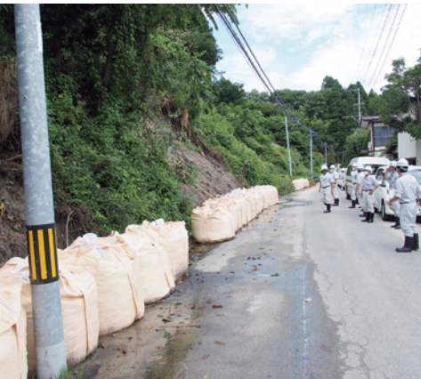
東高玉地内の豪雨災害現場
