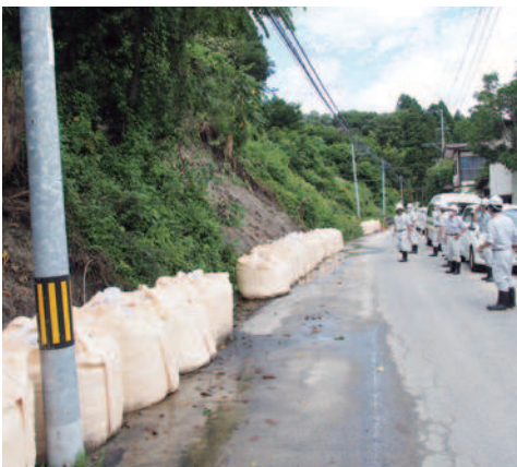
東高玉地内の豪雨災害現場
