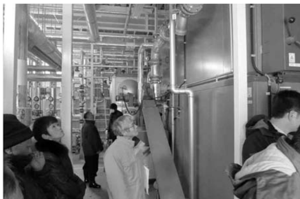
ウェルネスタウン（木質焚き温室ボイラー施設）
