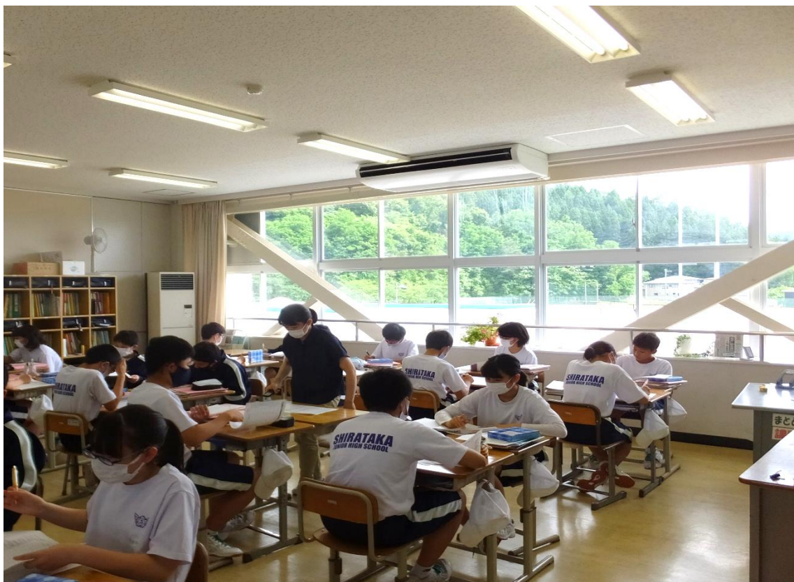
写真3-1 エアコンの整備状況(白鷹中学校普通教室)
