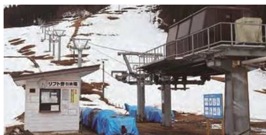
修繕を待つペアリフト
