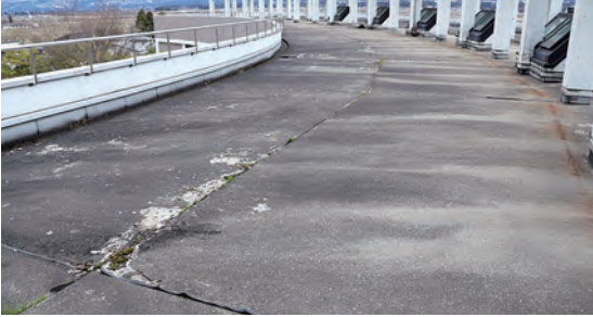
屋上のひび割れが雨漏りの原因
