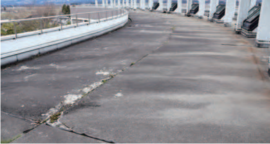
屋上のひび割れが雨漏りの原因
