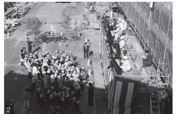
1_工事の安全を願って執り行われた神事 2_空から降ってくる餅やお菓子に大はしゃぎの園児たち
