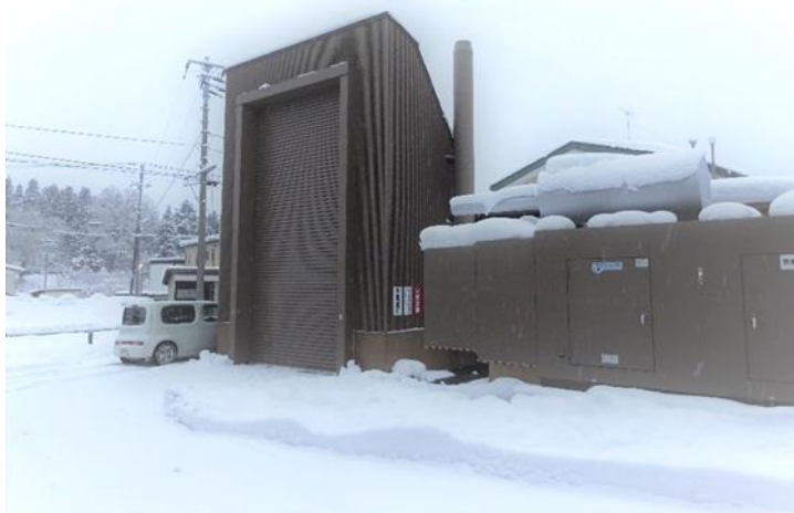
エネルギー棟(チップボイラー搬入口)
